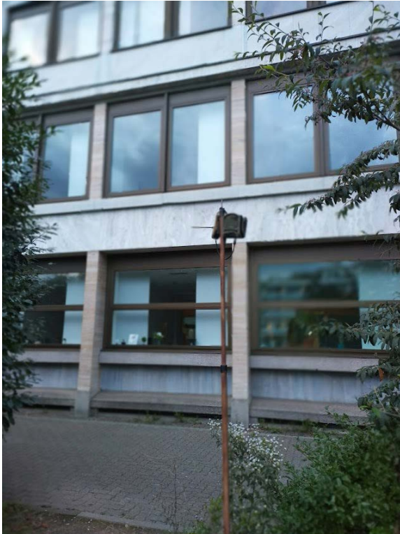
Abbildung 15: Potenziell für die Zwergfledermaus geeignete Spaltenquartiere (Rollladenkästen) mit in unmittelbarer Nähe aufgestelltem akustischen Aufnahmesystem (batcorder) zur Kontrolle ausfliegender Tiere.
