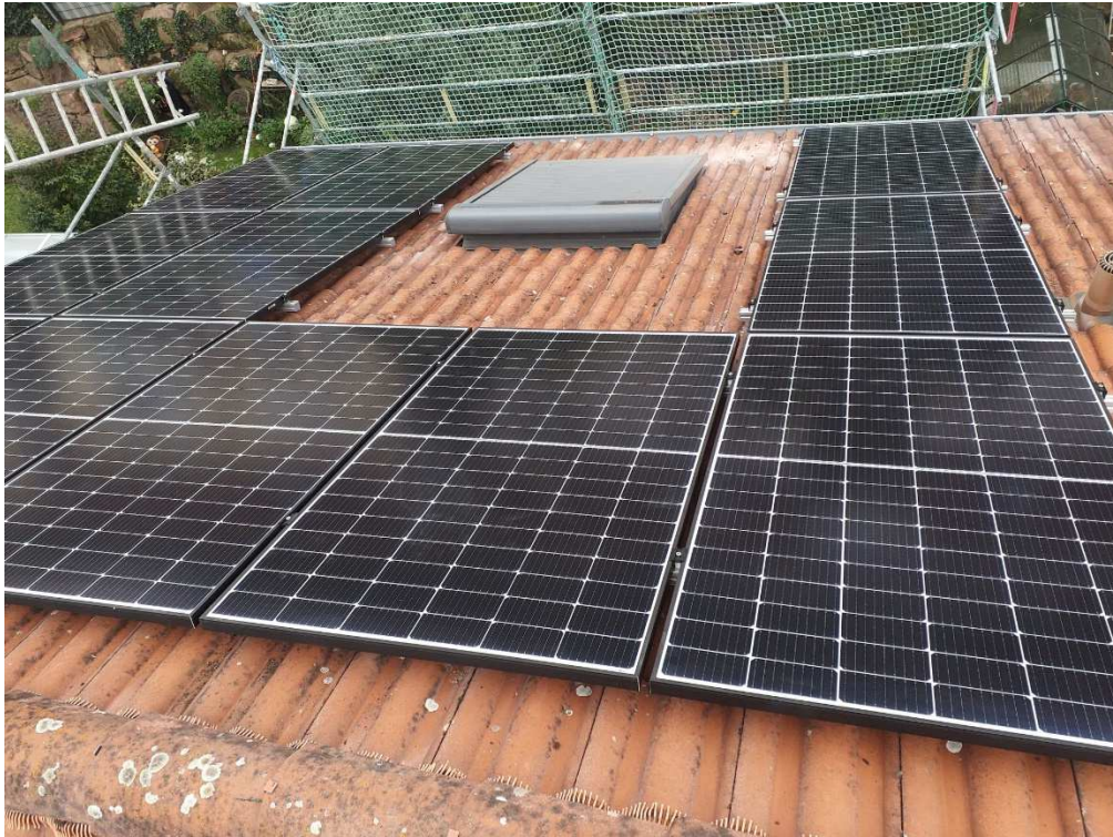
PV-Module Dach nach Osten
