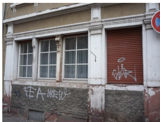
Foto 4: Sanierungsbedarf in den Seitenstraßen
